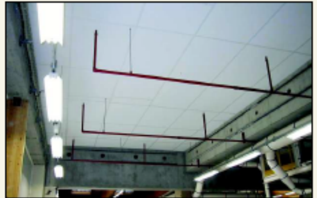
Plafond absorbant parallèle au sol.
